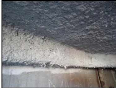
Photo N° 662 AMIANTE CIMENT -- LOCAL POUBELLE Conduits Ventilation haute (Fibres-ciment)
